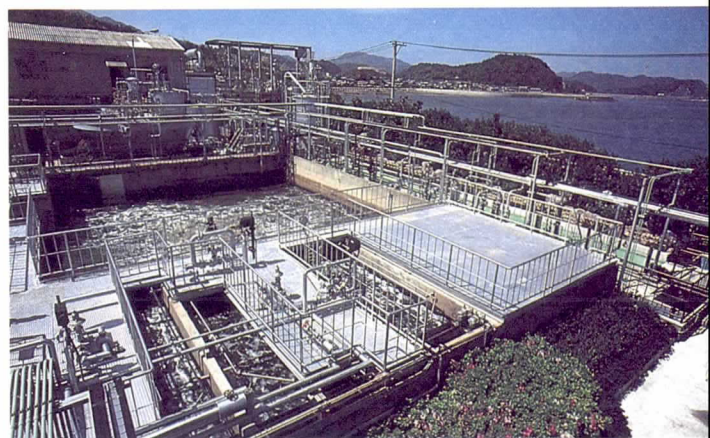
九州工場の水処理装置
