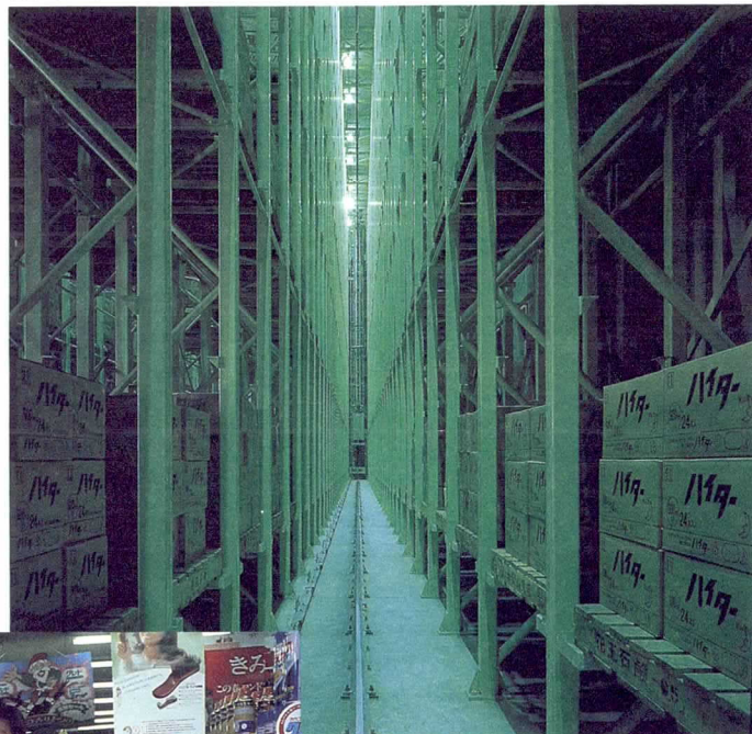
自動倉庫内部
