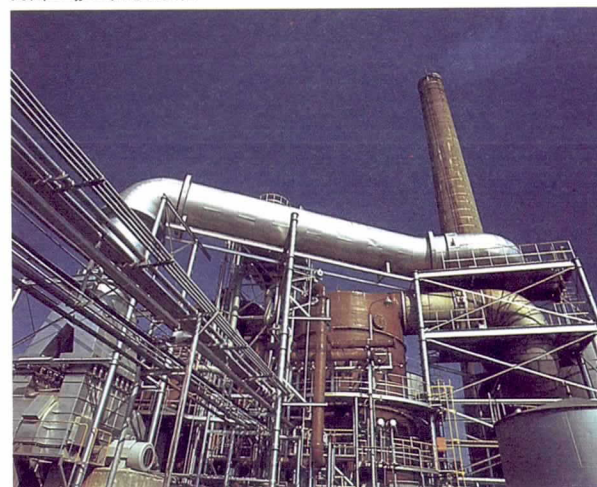
排煙脱硫装置
